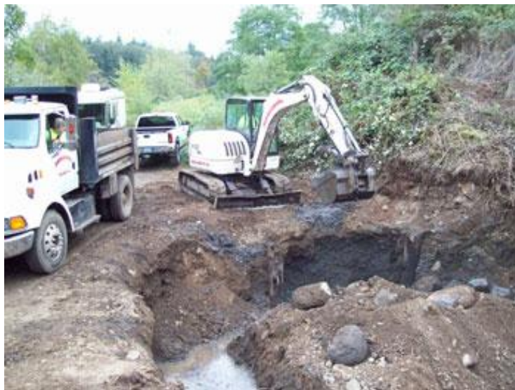
ภาพที่ 1 การตัดดินปนเปื้อนไปฟื้นฟู (contaminated soil excavation)
